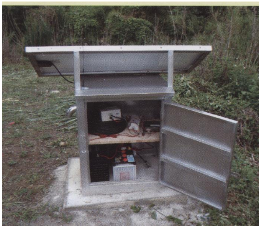
Рисунок 5.6 – Станция автоматического мониторинга уровня воды. (Soil and Water Conservation Bureau, SWCB).
