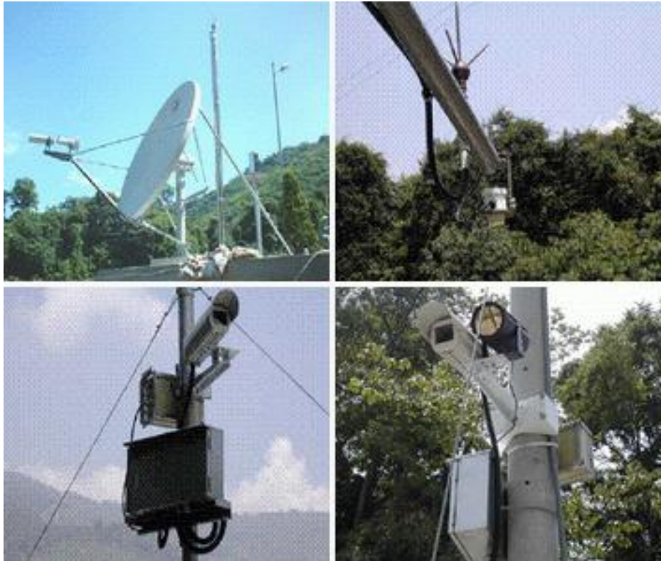
Рисунок 5.11 – Станция селевого мониторинга в г. Фенгкю (Fengqiu) округа Нанту. (Soil and Water Conservation Bureau, SWCB)
