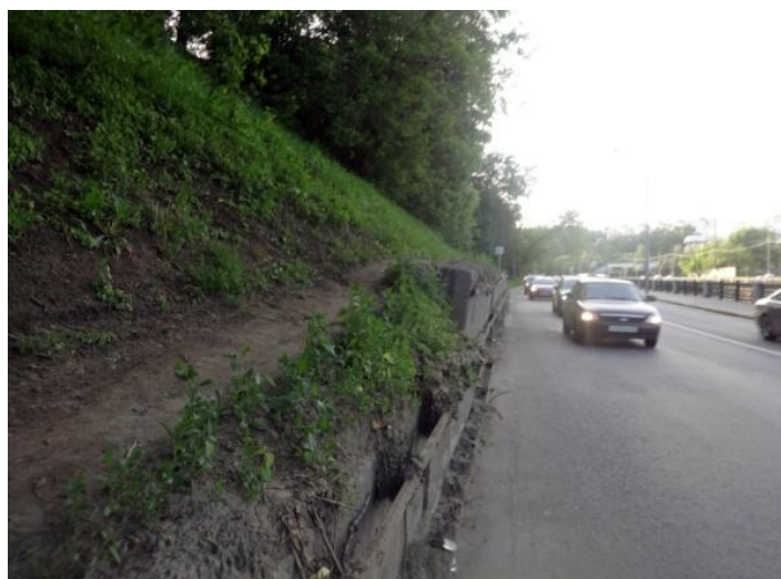
Рисунок 6.34у – Николо-Ямская набережная. Оползневые массы уничтожили тротуар. Подпорная стенка склона (Фото В.Б. Сваловой)
